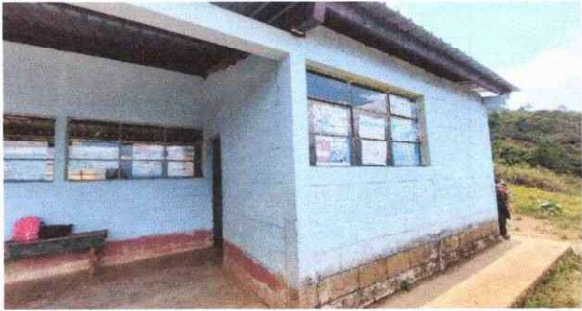
FOTO 1: DETERIORO DE PINTURA DE ESTABLECIMIENTO
