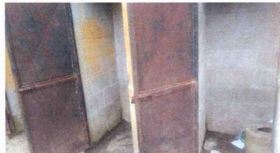
FOTO 4: DETERIORO DE SANITARIOS DEL ESTABLECIMIENTO
